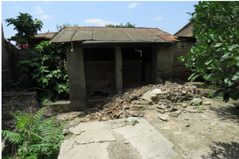
تصویر شماره ۱۱ - بخش تخریب شده قسمت شمالی
